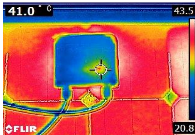
出力低下モジュール3 サーマ画像4
