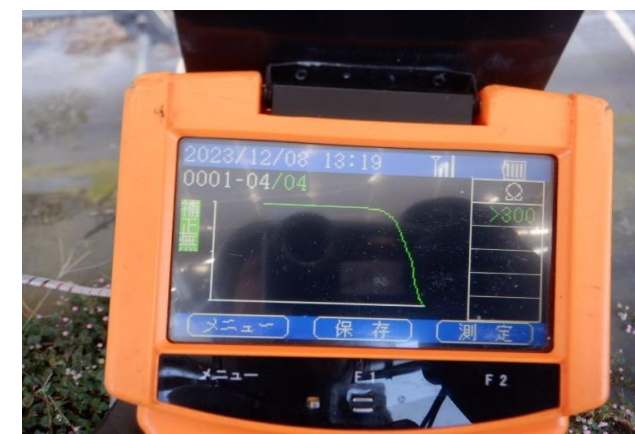
出力低下モジュール4 IVH測定
