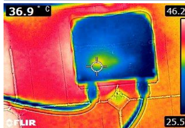
出力低下モジュール5 サーマ画像4
