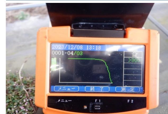
出力低下モジュール5 IVH測定
